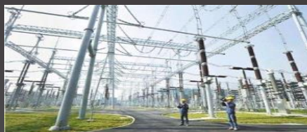
昌吉-古泉±1100kV超高压输电工程
